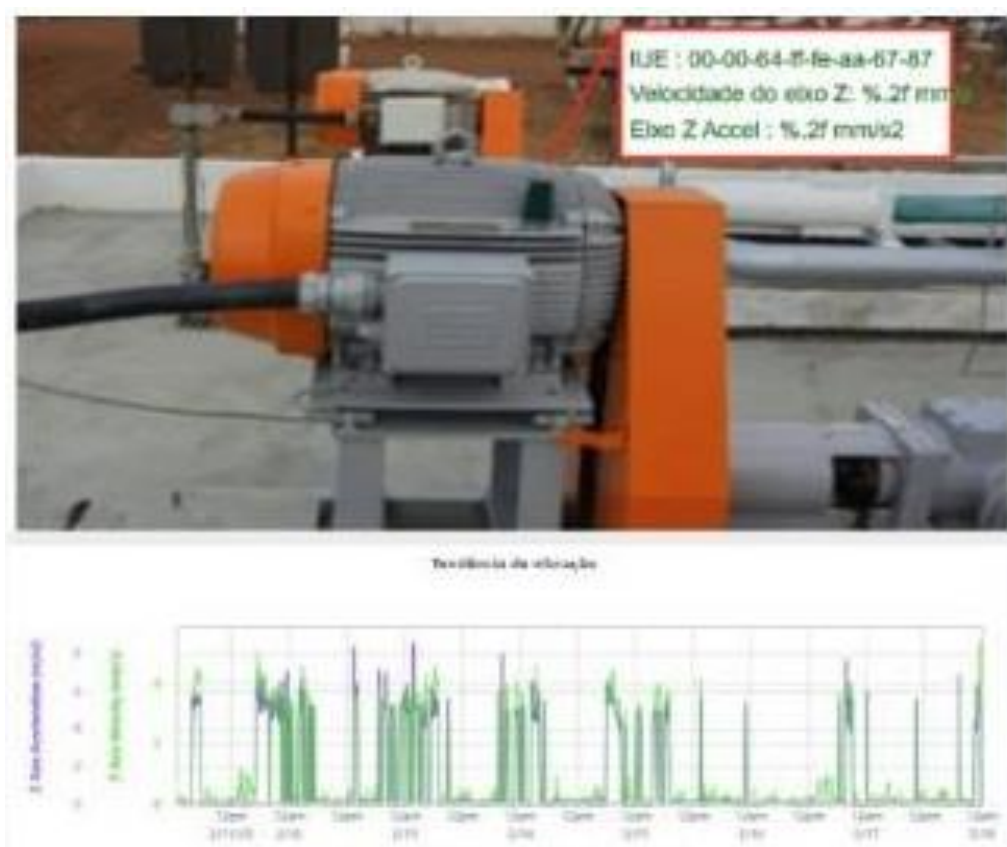
Figura 8 – Tela de supervisão de vibração do motor (autoria própria, 2023).
