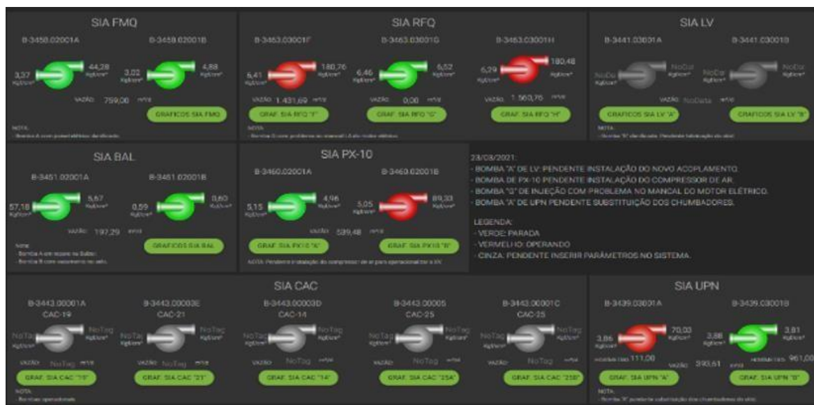
Figura 5 – Painel de acompanhamento de dados operacionais e paradas das bombas
