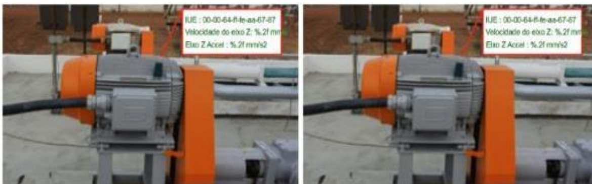
Figura 5 – Coleta dos dados vibracionais da bomba (autoria própria, 2023).
