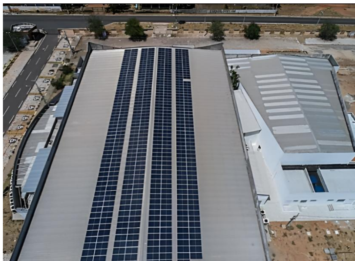
FIGURA 7. Vista superior das Usinas Solares Mossoró V e VI de 185,65 \text{ kWp} (adaptada de [9]).
