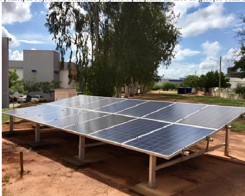
FIGURA 2. Mini usina solar fotovoltaica Mossoró I de 3,43 kWp (adaptada de [9]).
