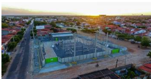
Fig. 1. 77ª Subestação de Mossoró localizada no bairro Belo Horizonte. Fonte: Site Neoenergia.
