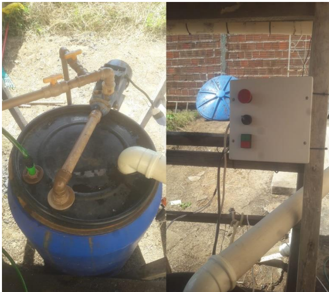
Fig. 4. Tubulação e quadro de comando instalado.
